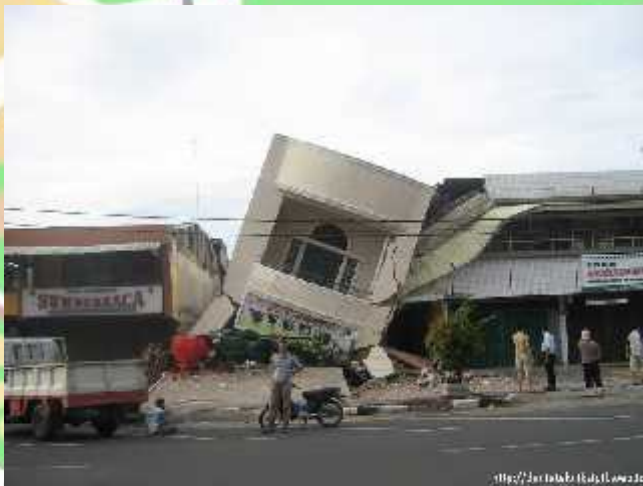
Gambar 1.1 Kegagalan Struktur Bangunan Gedung Pasca Gempa
