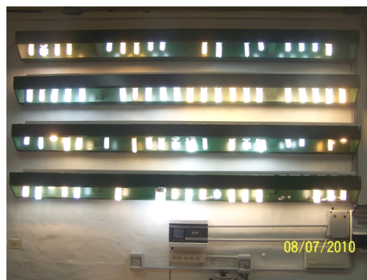
Fig. 1. Detalle del Rack de prueba de instrumentación.
