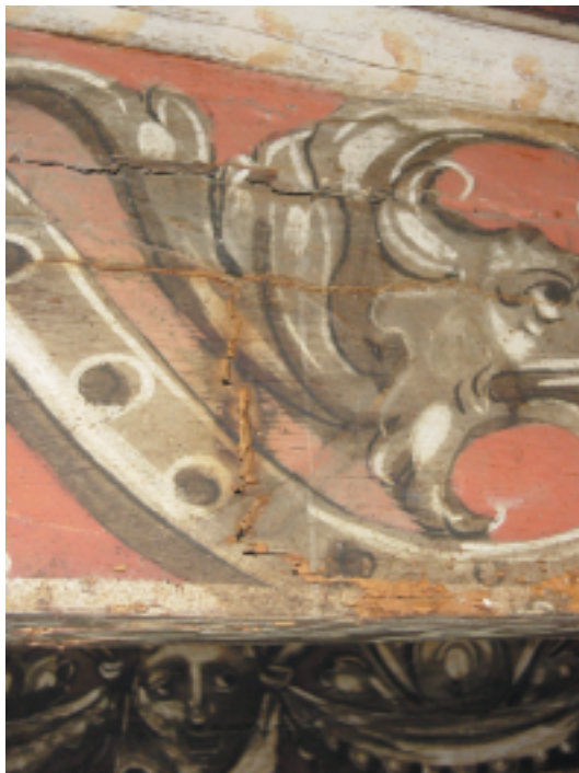
Imagen 4.- Rotura a flexión de una viga en el centro del vano.
