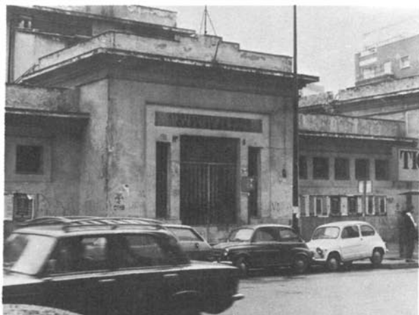
Las patologías constructivas en este edificio se derivan del uso continuado del mismo, con un alto nivel de humedad interior, junto a un deficiente planteamiento constructivo. Los petos de fachada realizados con mortero de cal han producido una disgregación total de la fábrica.
