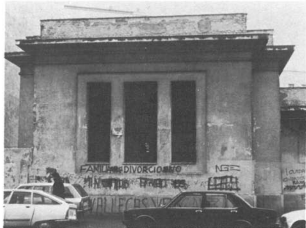
Las carpinterías metálicas han sufrido una fuerte oxidación que impide su cierre y apertura.
