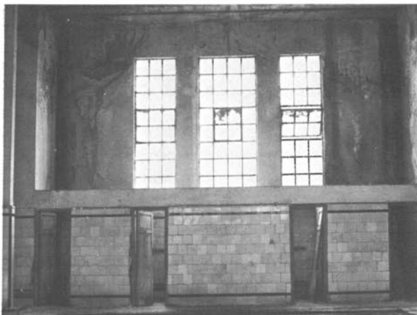
Dstrucción de pinturas y enlucidos por bajantes obturadas.
