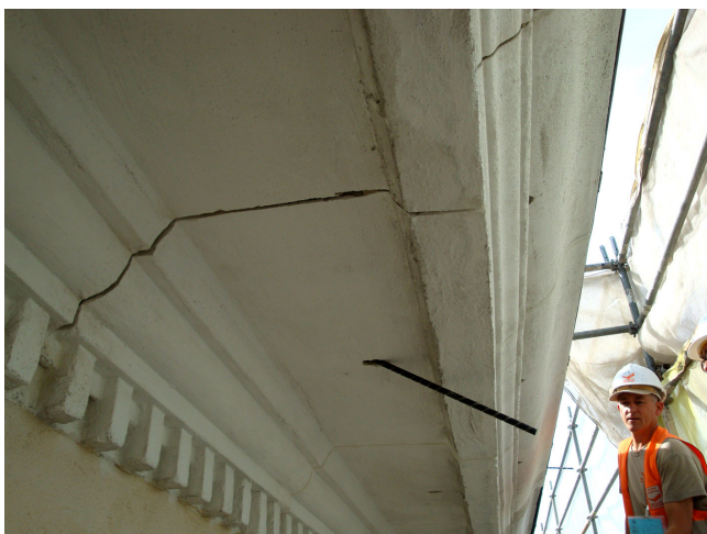
Figura 7. Anclaje que atraviesa la moldura base.
