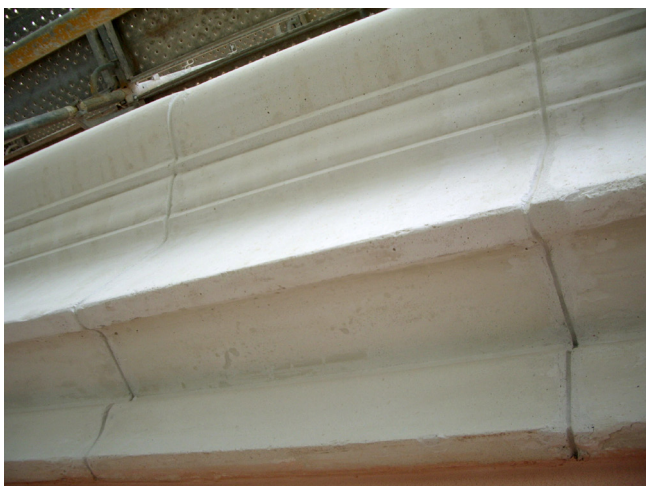
Figura 12. Juntas de cornisa superior.
