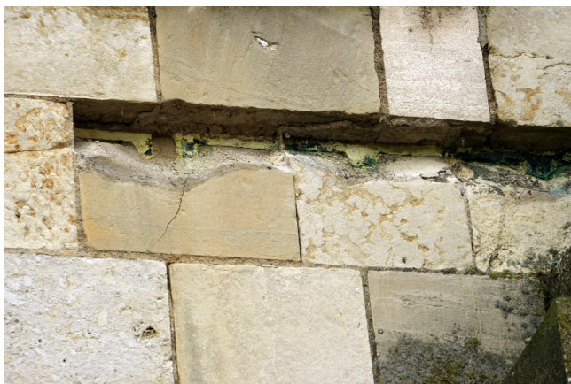
Figura 5. Vista de la cata que se efectuó en el gablete del hastial sur, en su cara norte y parte este del mismo donde se aprecia la corrosión de las grapas de bronce y la microfisuración del azufre del retacado (2009).
