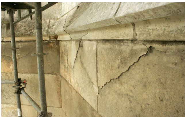
Figura 7. Vista de uno de los paramentos del hastial sur donde se aprecia la fractura de sólidos típica que produce esta patología (2009).
