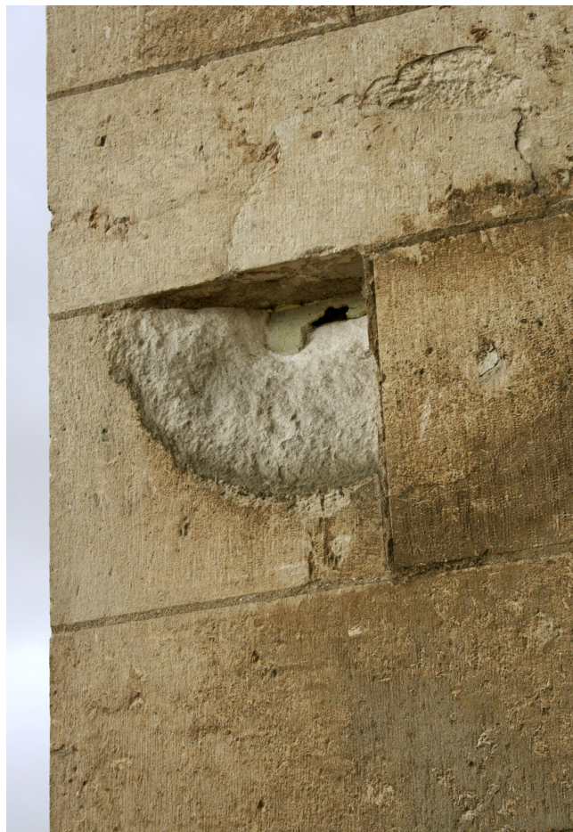
Figura 8. Vista de la rotura del sólido producida por un engrapado de hierro retacado con azufre en el paramento este del contrafuerte que forma parte de la escalera de caracol este del hastial sur de la catedral de León (2011).
