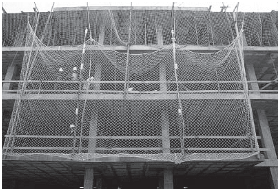
Figura 1. Red vertical de seguridad.
