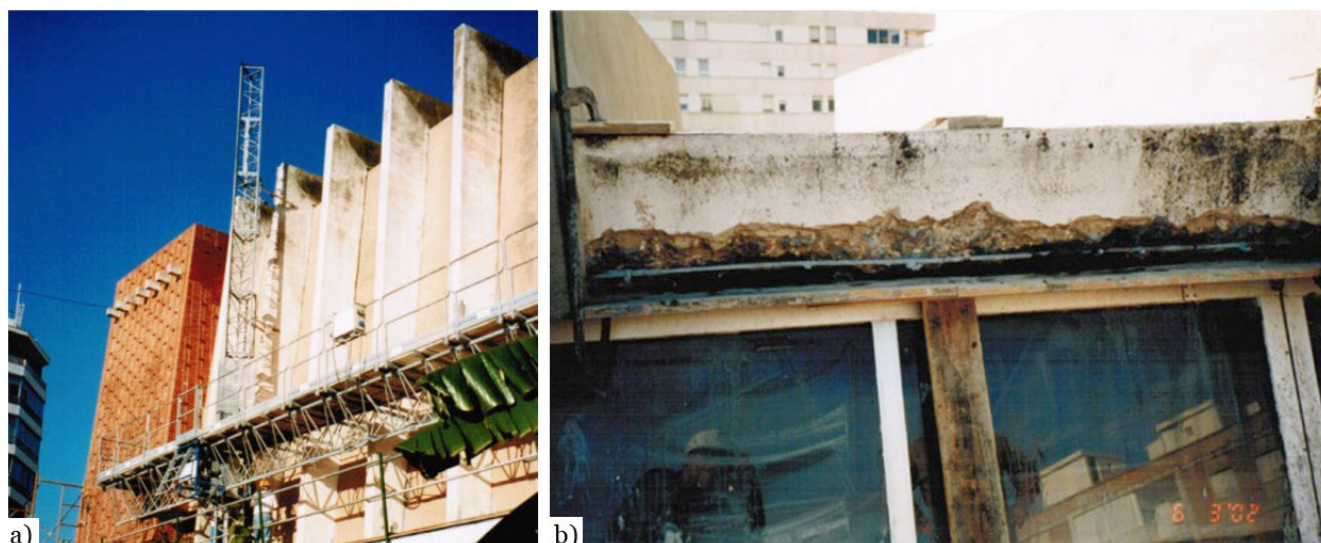
Figura 6. Estado que presentaba los elementos estructurales de la fachada Sur: a) Pórticos-costillas, b) Detalles de la pérdida de recubrimiento de la losa. (Lafuente, I. 2002).
