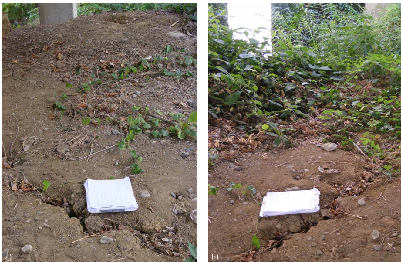
Figura 5 a y b. Grieta en corona del talud, evidenciando la existencia de pequeños deslizamientos.
