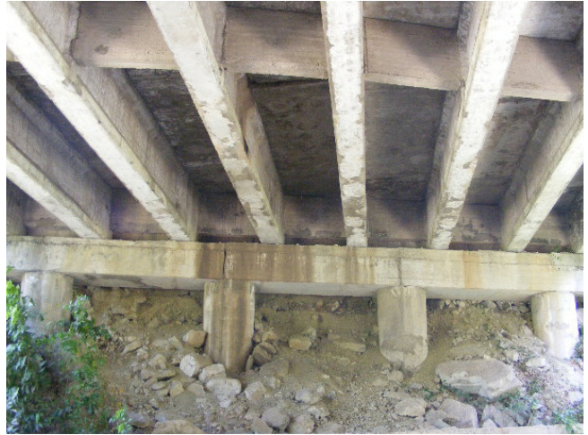
Figura 7. Deslizamiento del material del aprоче entre las columnas del estribo.
