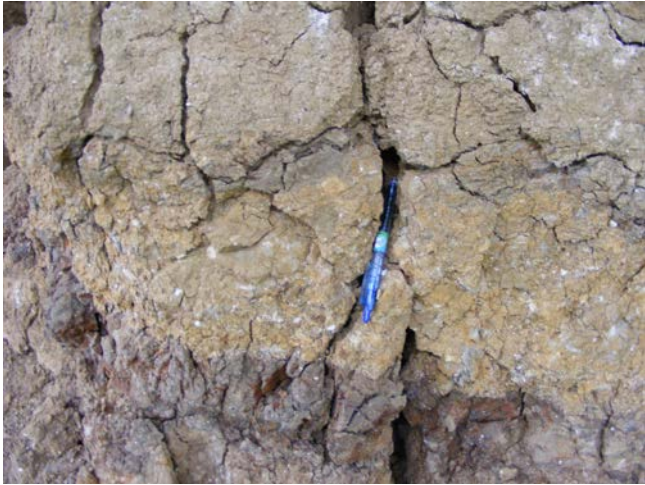
Figura 6. Grietas por desecación en el talud del cauce del río, formado por suelos arcillosos expansivos. Desprendimiento del material arcilloso. Destrucción parcial del talud.
