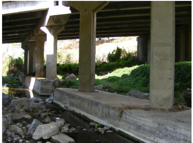
Figura 9. Socavación al pie de pilas que deja al descubierto parte de la cimentación.
