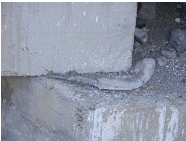
Figura 10. Aparatos de apoyo inadecuados sobre cabezales de pilas.
