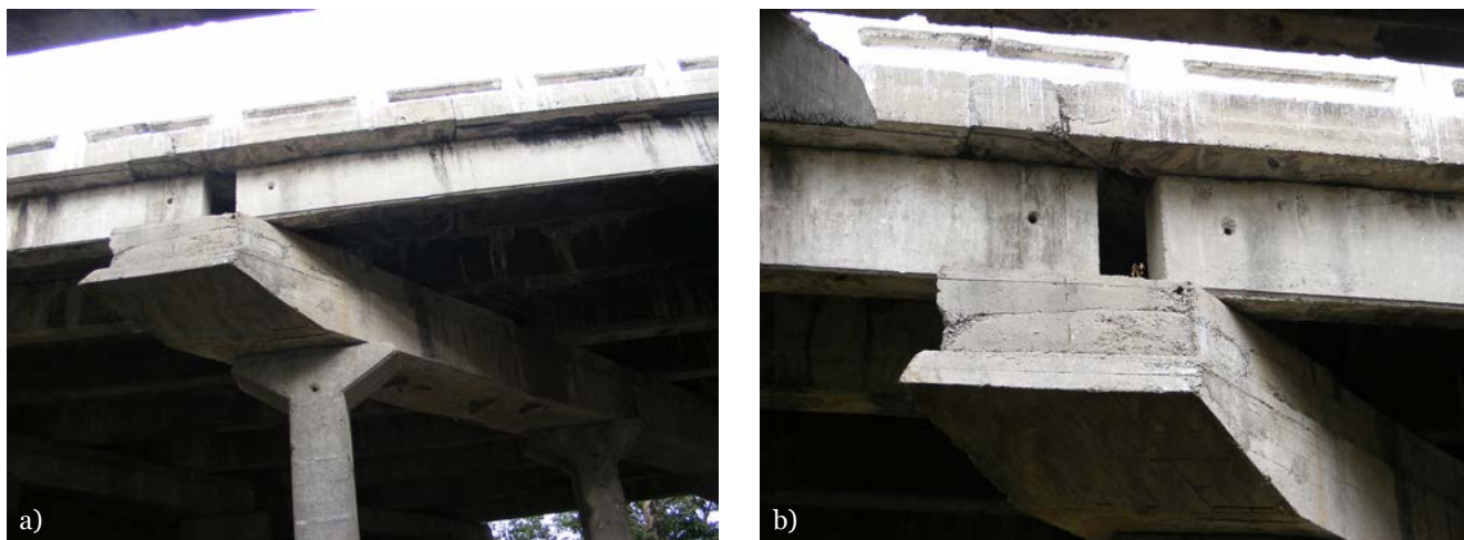
Figura 4 a y b. Longitudes de apoyo inadecuadas sobre cabezales de pilas.
