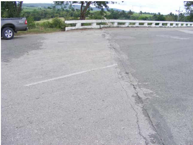
Figura 8. Hundimiento de la losa de aprоче en ambos extremos.
