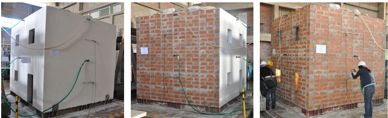
Figura 9. Prototipo 2, de ladrillo, después del ensayo sin apenas fisuras.
