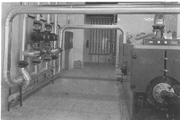
Sala de calderas.
