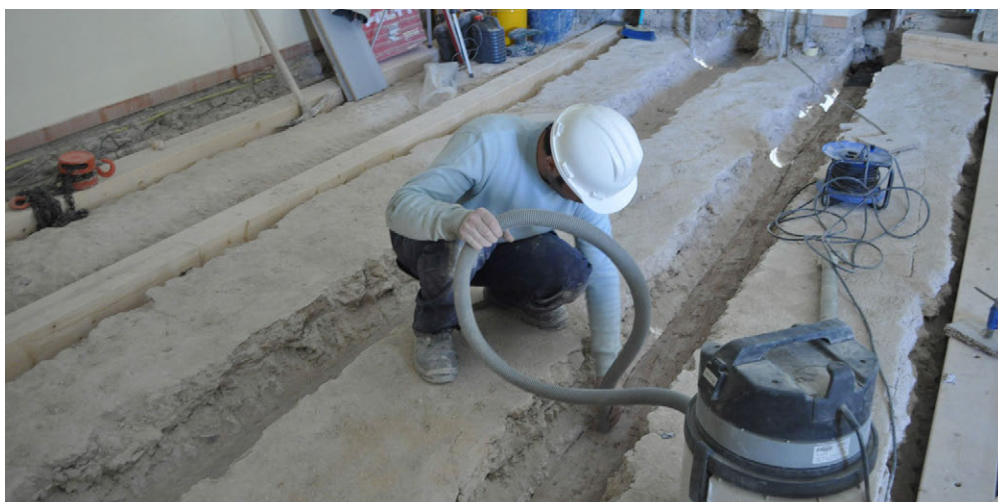
Figura 9. Trabajo de limpieza de las vigas de madera antes de su encolado. Se puede observar el cajeadado abierto en las bovedillas para la colocación de los refuerzos, y las vigas ya reforzadas.
