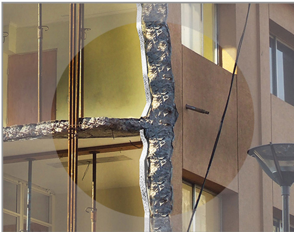
Figura 1. Fotomontaje que recrea la interrupción del material aislante en el encuentro del forjado y los muros perimetrales.
