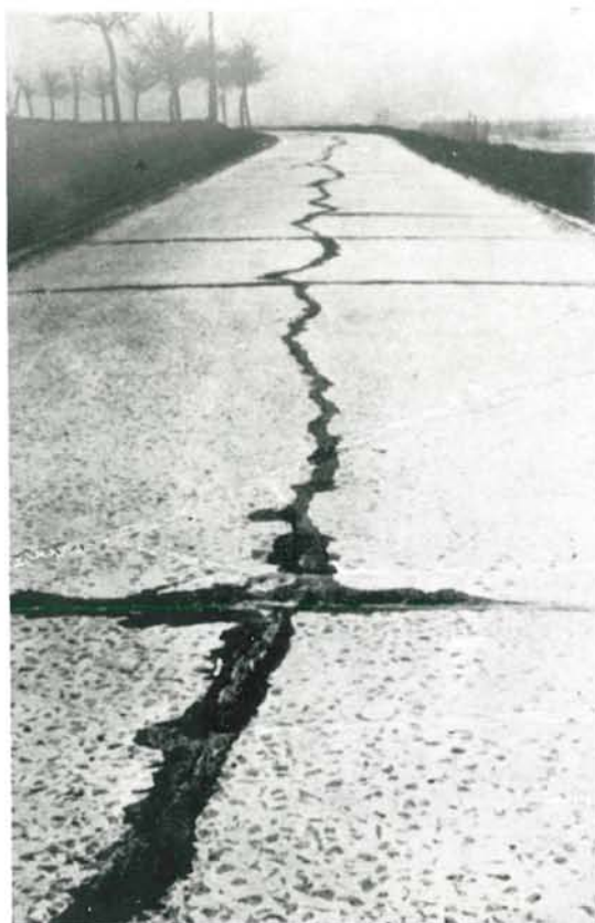
Fig. 1.—Grietas en una carretera antigua, originadas por la falta de juntas.
