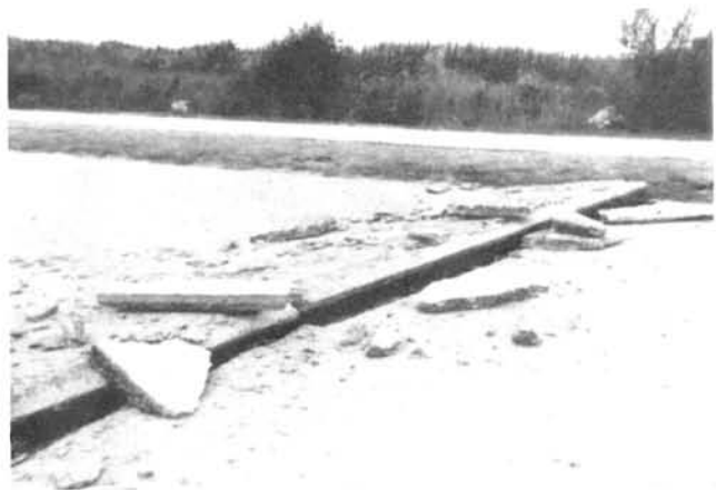
Fig. 15.—Rotura por pandeo, a una temperatura de 40° C.
