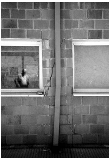
Fig. 14. Deformación de bajante metálica.
