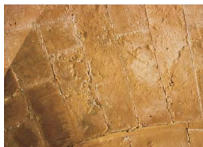
Fig. 43. Pátina de sulfato cálcico en interior de bóveda de piedra por filtración.
