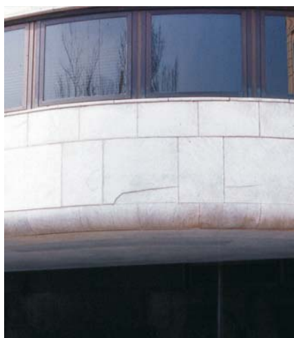
Fig. 19. Fisura de chapado por dilatación.
