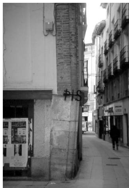
Fig. 10. Pandeo y desplome de muro de carga.
