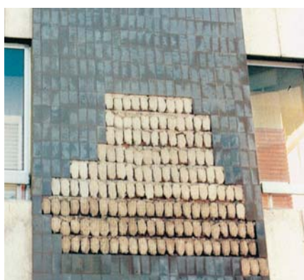
Fig. 21. Desprendimiento de alicatado "a hueso".
