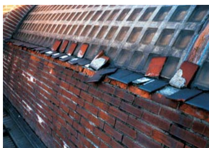
Fig. 22. Desprendimiento de vierteaguas por falta de solape.
