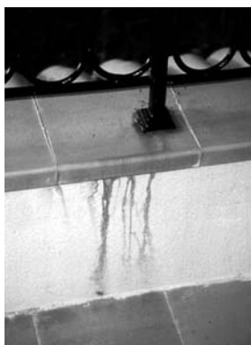
Fig. 30. Churretón de óxido por falta de imprimación de patilla.
