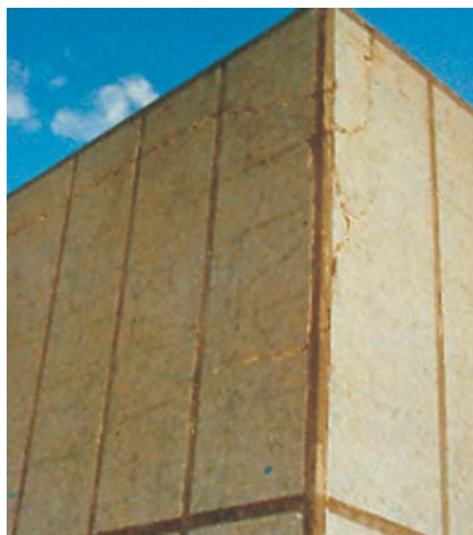
Fig. 20. Fisuras en mosaico por retracción higrotérmica.
