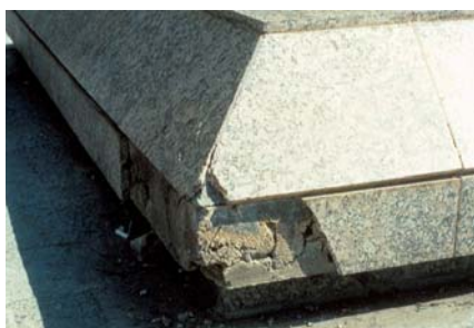
Fig. 24. Desprendimiento de chapado por debilidad solución en inglete.
