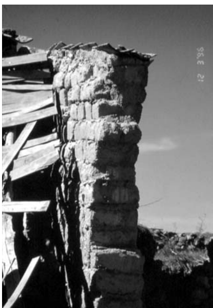
Fig. 12. Alabeo de muro de adobes.
