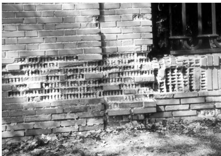
Fig. 8. Erosión física por helada.
