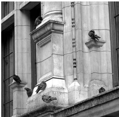
Fig. 34. Presencia de palomas en resaltes de fachada.
