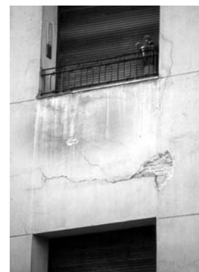
Fig. 17. Grietas por movimiento de dintel.
