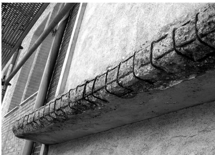
Fig. 29. Corrosión de armaduras próximas a superficie.
