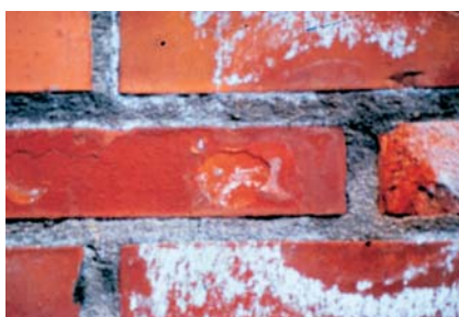
Fig. 27. Eflorescencias y criptoflorescencias en ladrillo.
