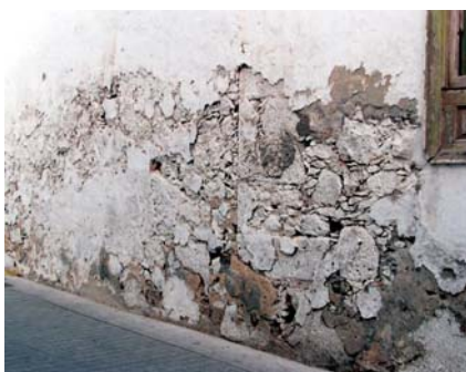
Fig. 2. Humedad de capilaridad en muro de fachada.
