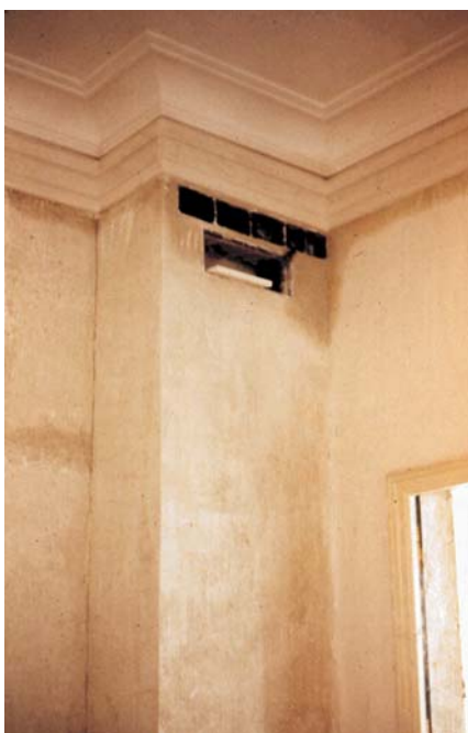
Fig. 1. Humedad de obra en yeso.
