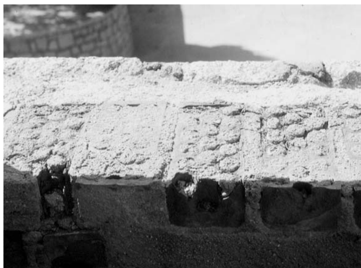
Fig. 9. Erosión física por helada.
