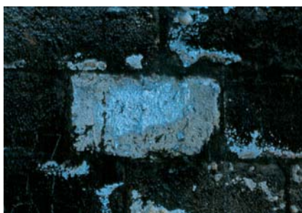
Fig. 42. Pátina de sulfato cálcico sobre fachada de piedra.
