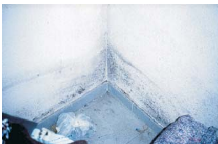
Fig. 4. Humedad de condensación por puente térmico.
