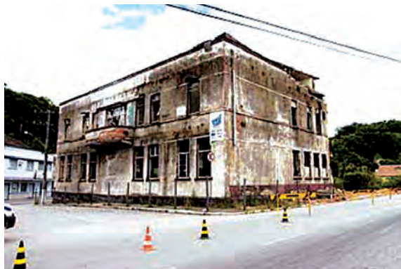
Figura 2 Edificio principal de la Fábrica de Gaitas Alfredo Hering en proceso de abandono y deterioro. La Fábrica fue una gran unidad industrial de instrumentos musicales y briquedos. Esta fue seriamente afectado por la apertura de las importaciones en 1992 y con la paridad de cambio en 1994, teniendo que concurrir repentinamente con los productos importados (asiáticos, chínense) y cerró sus actividades en la década de 1990. Fue abandonada por 15 años y después demolida en 2005. (Fuente: Jornal de Santa Catarina, 05/12/2005)
