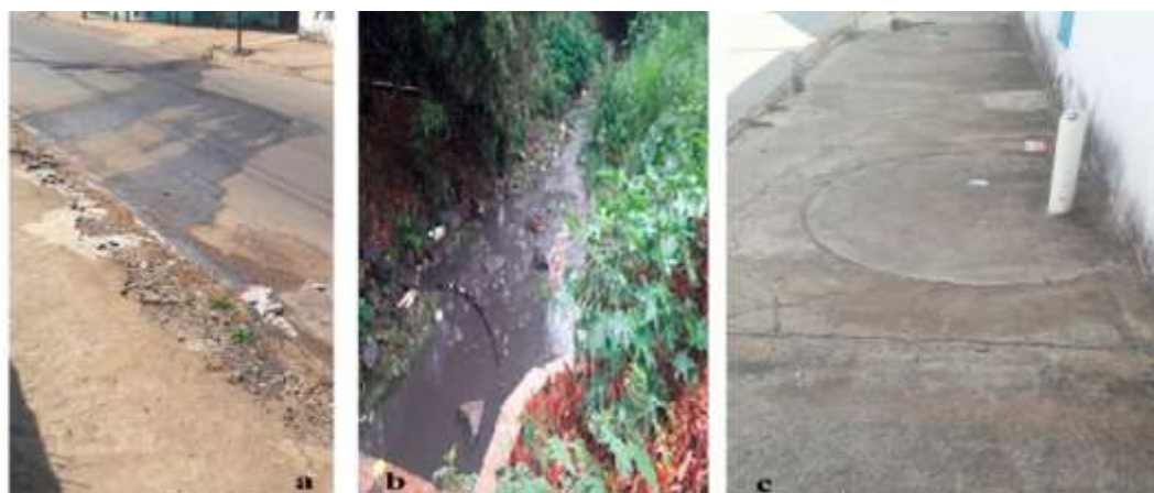
Figura 2: a- Setor Coimbra, esgoto a céu aberto, lixos e calçada deformada. b- Setor Coimbra, grande quantidade de lixo no Córrego Cascavel. c- Setor Santa Tereza a existências de fossas. Zona 3.
