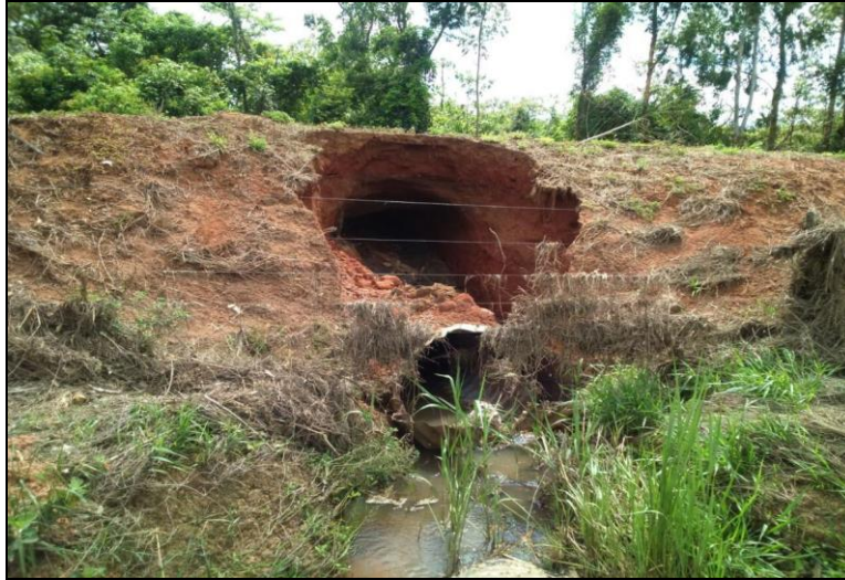
Figura 6 - Erosões sobre o bueiro
