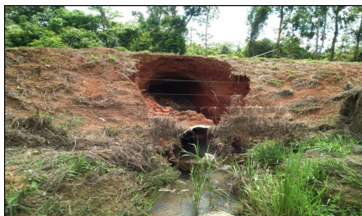
Figura 4 – Erosões sobre o bueiro
