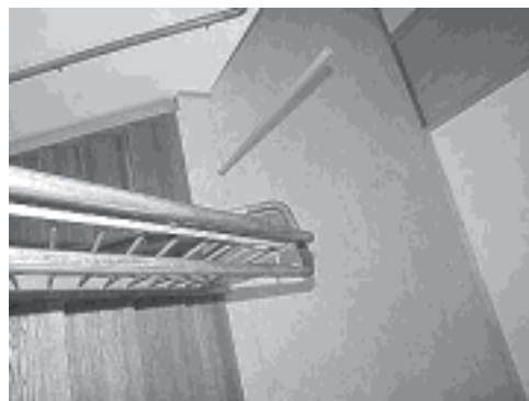
写真-5：階段に設けられた簡単な車椅子転落防止バー
