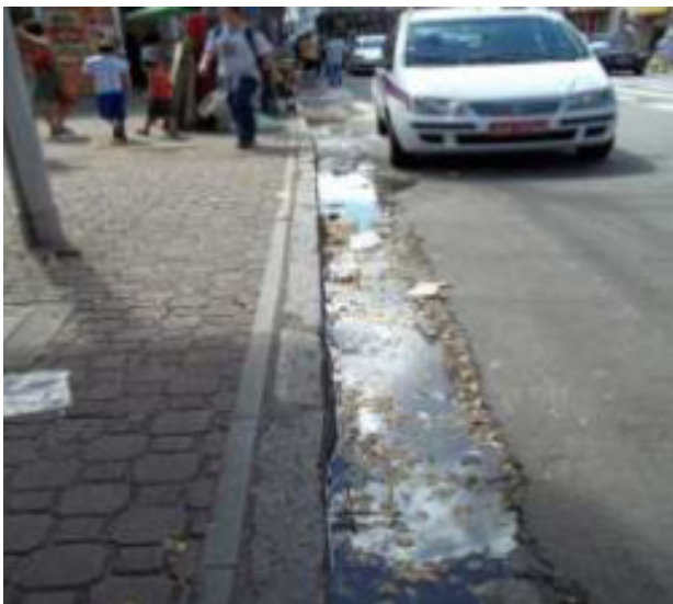
Figura 3. Drenagem precária de águas inservíveis, Rua Carlos Gomes - Centro, 2012
