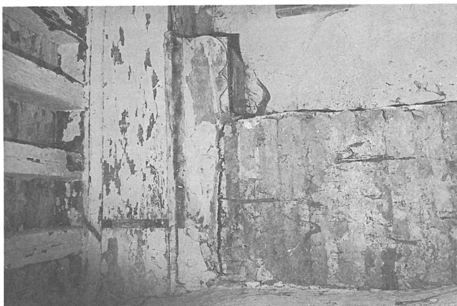
Detalle de pilar, zapata, jácena y alfarje de la galería Sur del patio del Maristán. (Foto García Granados)
