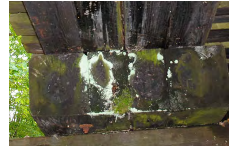
Bent 3 - Corbel 2 Rot
