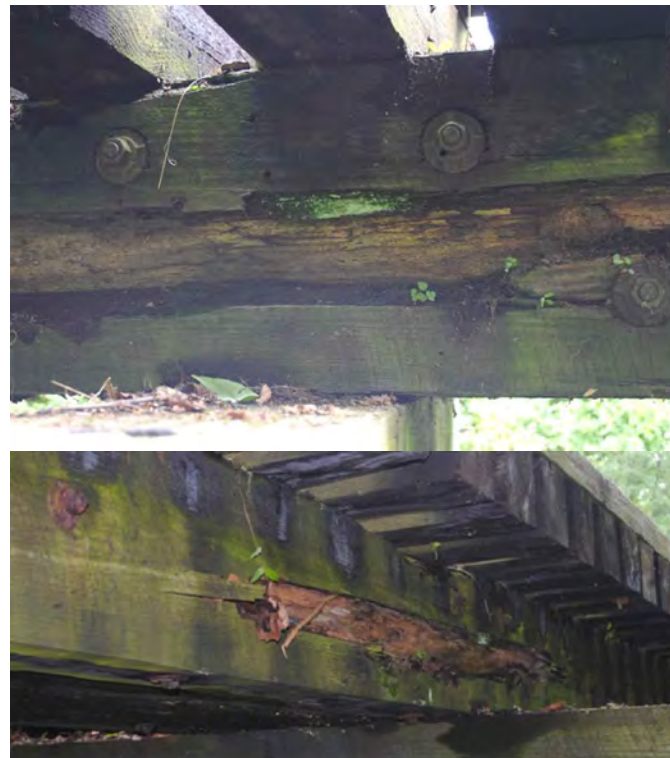
Span 3 & 4 - Stringer 8 Rot
