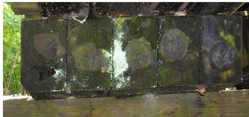
Bent 2 - Corbels 1, 2 & 3 Rot
