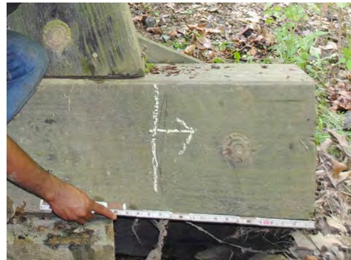
Bent 2 - Sill Rot
