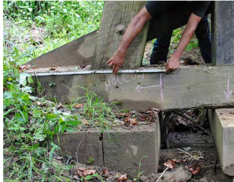
Bent 3 - Sill Rot
