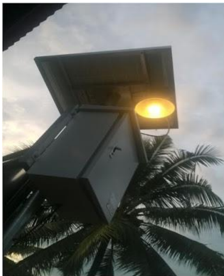
Gambar 6. PSU tenaga surya yang IBP
