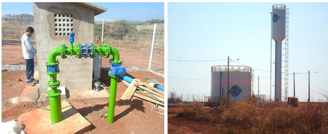
Figura 3 – Mosaico: Poço Tubular Profundo, Centro de Reservação e esquema individual de efluentes em Trindade-GO em 2016. Fonte: Os autores.
