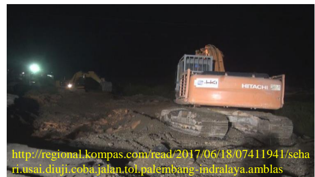
Gambar 2. Jalan tol Palembang-Indralaya amblas
