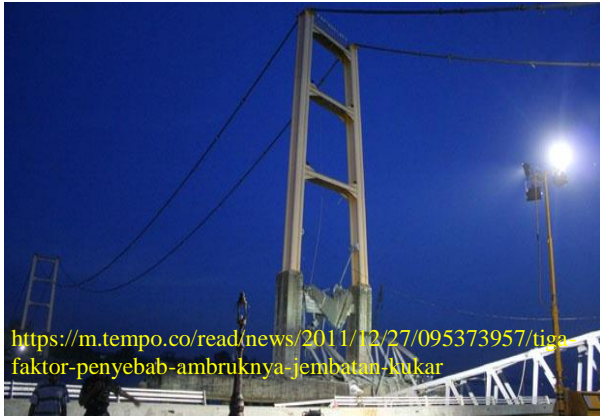
Gambar 3. Jembatan Kukar ambruk
