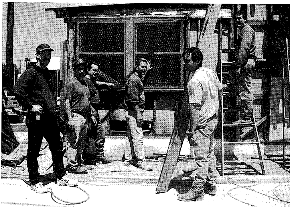
校舎建築中のディランシー・ストリート・ファウンデーションのメンバー
