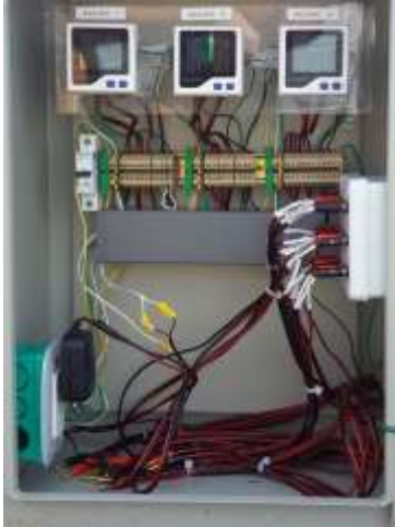
Figura 4. Vista interior del tablero DC. Fuente. Elaboración propia.
