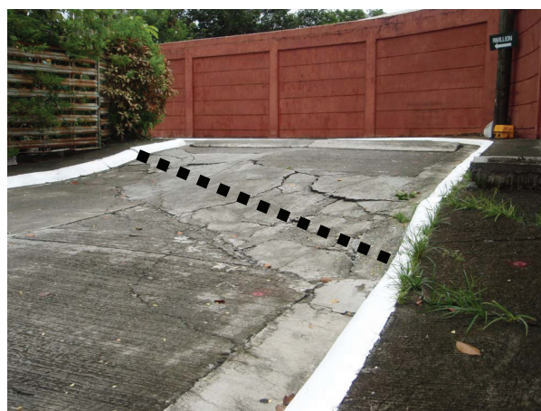
写真 1 断層クリープによる変位で生じた道路段差 点線：断層位置
