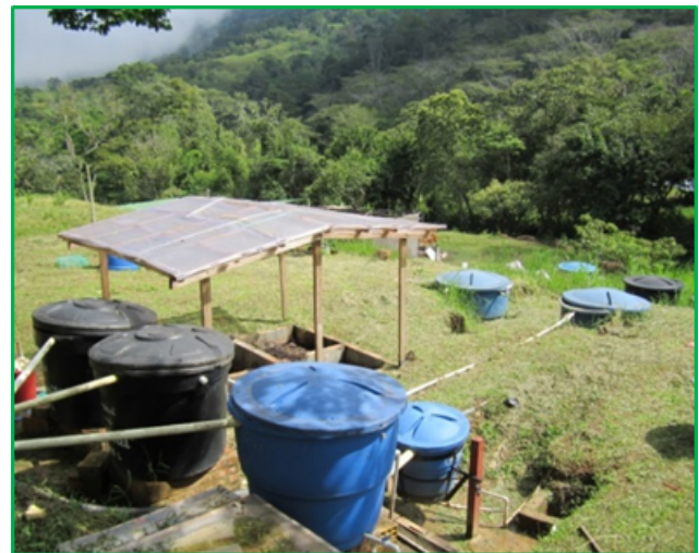
Fotografía 3. Sistemas de tratamiento.
