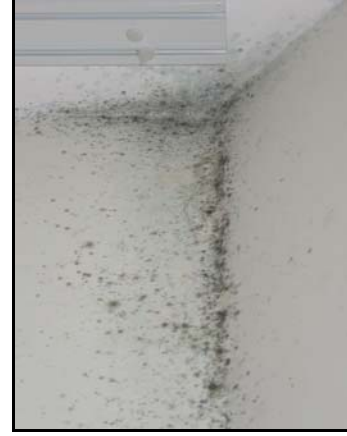
Şekil 8. İçten yalıtımda buhar kesici koyulmaması sonucunda tavanda oluşan küflenme.
