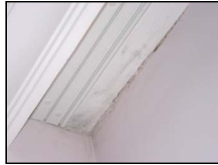
Şekil 9. İçten yalıtımda buhar kesici koyulmaması sonucunda tavanda oluşan küflenme.
