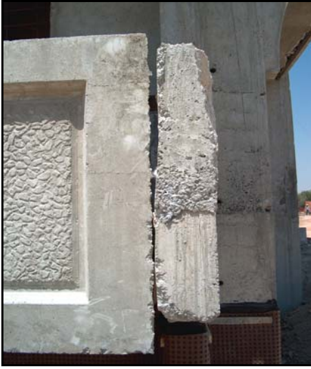
Şekil 6. Prekast balkon parapeti ve balkon duvarı arasındaki boşluk.
