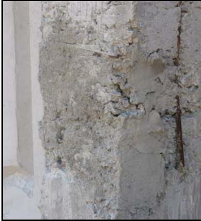
Şekil 5. Betonda meydana gelen dökülmeler ve sıva ile onarımı.
