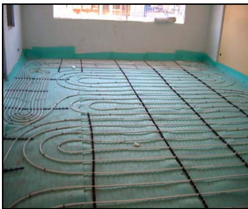
Şekil 11. Terlemeyi engellemek için yapılan ısıtma sistemi.
