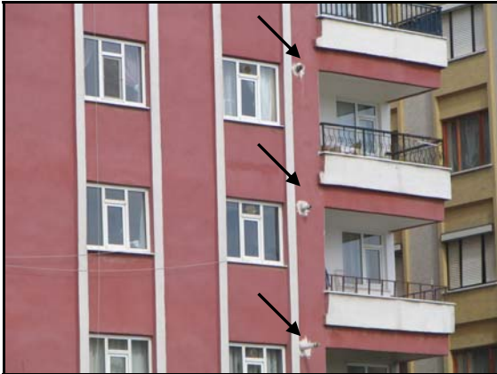
Resim 14. Hermetik bacaların bina cephelerine yansıması (Korkmaz arşivinden).
