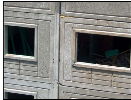
Resim 14. Cephe panellerinde meydana gelen bozulmalar ve kırılmalar.
