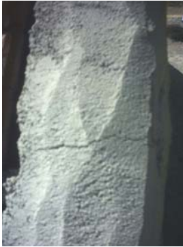
Şekil 13. Birinci yüklemeye oluşan hasar.
