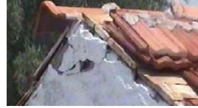
Şekil 10. Onuncu yükleme sonunda sıvalı kalkan duvarın tepe kısmının görünümü. Figure 10. The view of plastered gable wall at the end of the 10 th loading.
