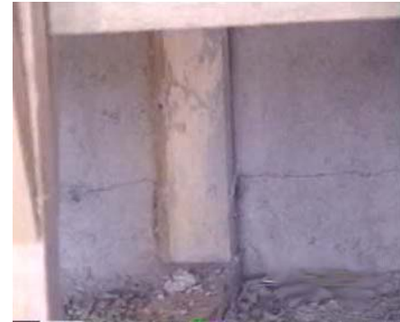
Şekil 12. İç sıvada oluşan çatlaklar. Figure 12. Occurred cracks for inside plaster.
