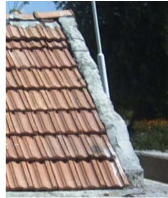
Şekil 16. Üçüncü yüklemeye sonrası sıvasız kalkan duvarın görünümü.
