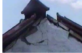
Şekil 6. Sıvalı kalkan duvar çatlaklarının görünümü. Figure 6. The view of plastered gable wall cracks.
