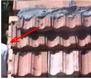
Şekil 3. Kiremitlerde oluşan kaymalar. Figure 3. Occurred sliding for tiles.
