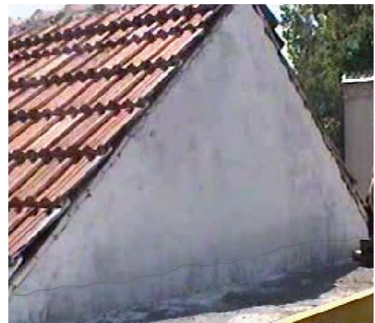
Şekil 1. Sıvalı kalkan duvarda oluşan kılcal çatlaklar.
