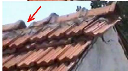
Şekil 7. Yedinci yüklemeye oluşan hasarlar. Figure 7. Occurred damages for 7 th loading.
