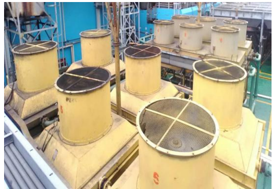
Gambar 7. Posisi Fan Radiator JW dan ICW
