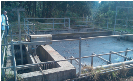
Defekte Kläranlage im September 2013
