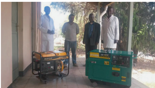
Die zwei Generatoren, welche in der Anfangszeit zur Überbrückung von Stromausfällen dienten...
