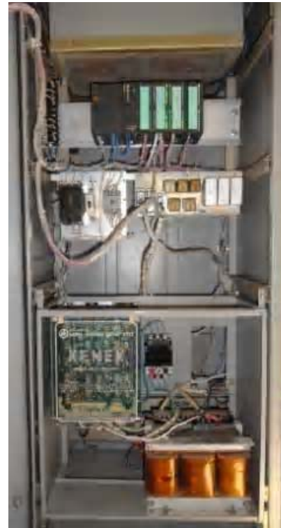
Рис. 3. Внутрішній вигляд переобладнаної шафи керування «Контур 1»
