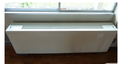
Fan coil unit
