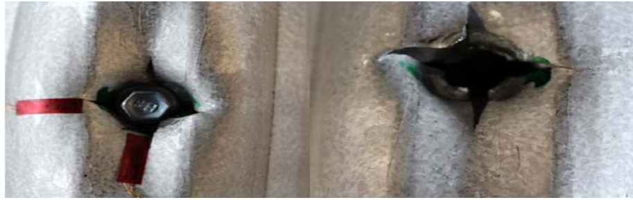
(d) Star-type crack
