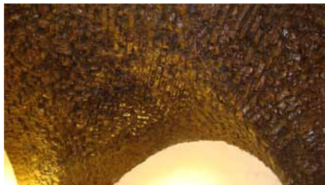
Fig. 20. Stopiony ceglany strop w kaplicy klasztornej opactwa Benedyktynów, fot. J. Dąbrowski • Molten roof bricks in the chapel of the Benedictine Convent in Jarosław, phot. J. Dąbrowski
