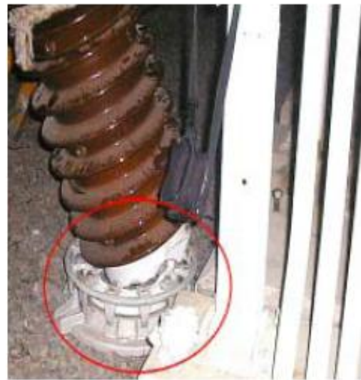
(d) Broken Support
