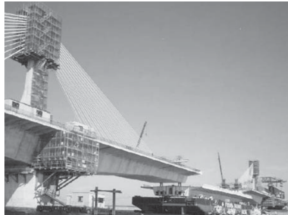
Figura 9. Erección de la viga metálica en el Puente Ibi Gawa en Japón.
