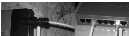
Figura 4. Conexión entre el acces point y el switch.
