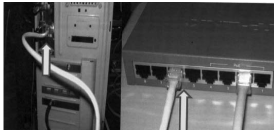
Figura 5. Conexión del switch al puerto Ethernet de la computadora.
