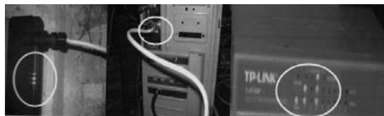
Figura 6. Verificación de que los equipos enciendan.
