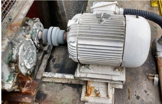
Figura 03 - Motor acoplado ao redutor
