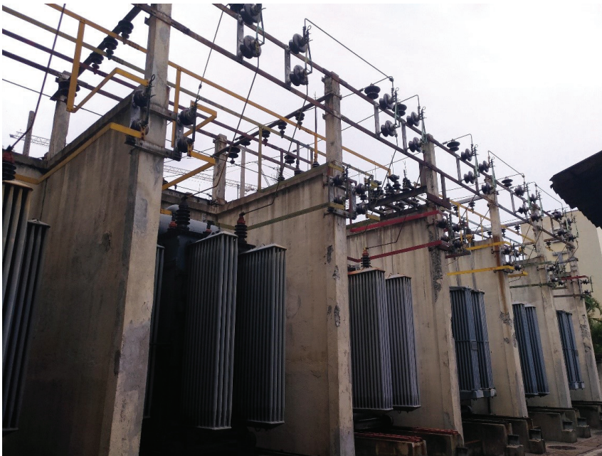
Figura 3: Transformadores da subestação do AMRJ.
