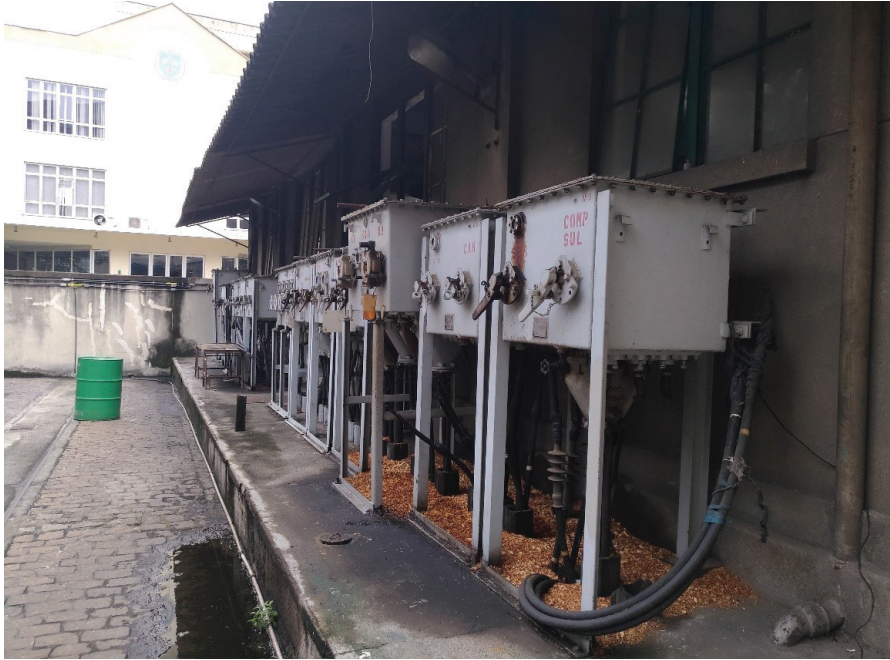
Figura 4: Chaves de manobra da subestação do AMRJ.
