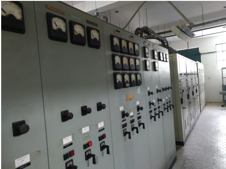
Figura 5: Quadro de comando da subestação do AMRJ.
