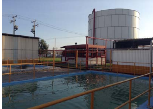
Fig. 1. Planta tratadora de agua Continental Tyre.
