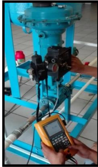
Figura 6 Calibración de la válvula neumática de control.
