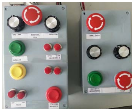
Figura 2 Tablero de mando.
