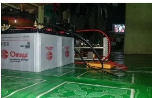
Gambar 3.4 pengujian listrik 1 rumah daya 535 watt (Sumber : Foto Dokumentasi)
