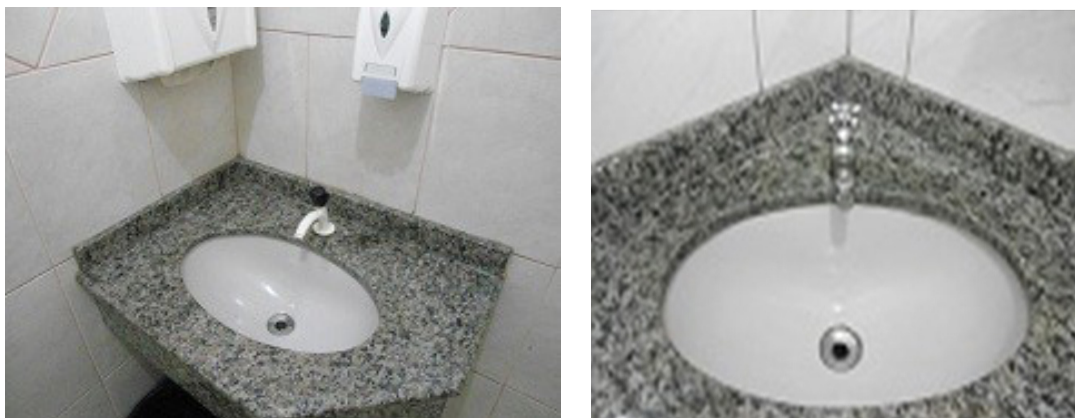
Figura 2. Torneiras disponibilizados nos banheiros do polo
