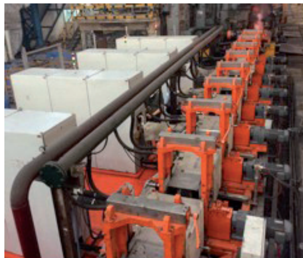
Fig. 15 – Stazione ad induzione da 6 MW con 8 moduli
